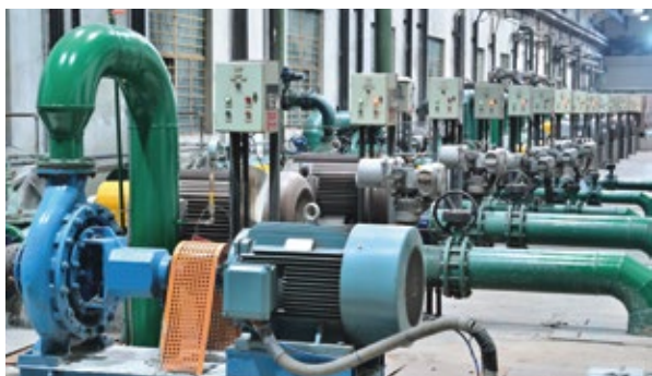
Installation de traitement de l'eau : pompes et pipelines
